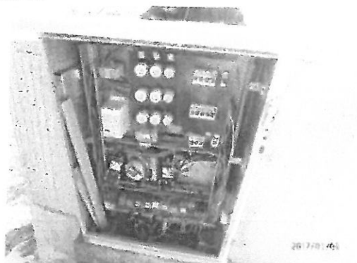
Erdősor utcai átemelő vezérlés
