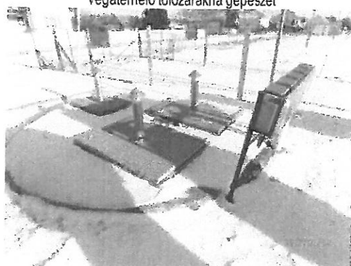
Újerdő utcai átemelő
