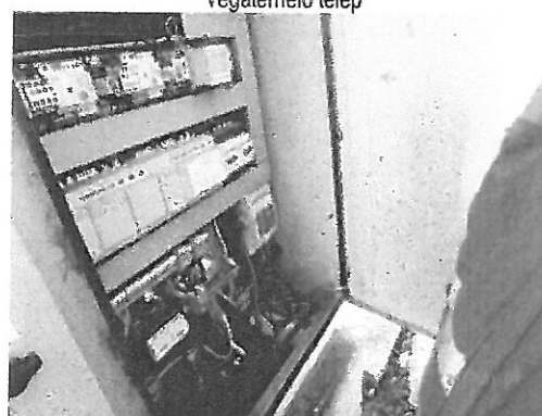
Végátemelő vezérlés és lágyindítók
